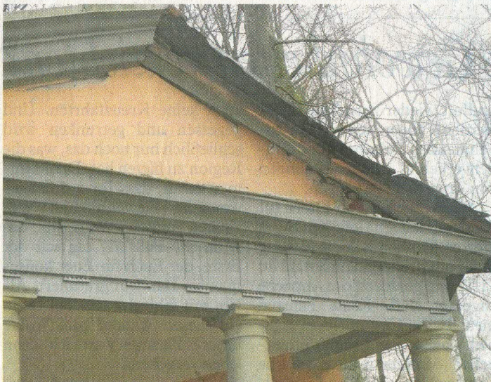
Der beschädigte Pavillon im Januar 2018
